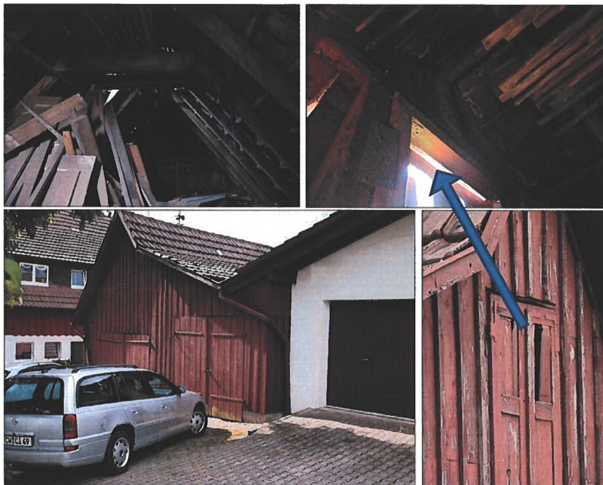
Abbildung 3: Hühnerschuppen mit Holzverkleidung und Dachstuhl Zugangsmöglichkeit über ein nicht dicht verschlossenes Fenster am südlich ausgerichteten Giebel (s. Pfeil).
